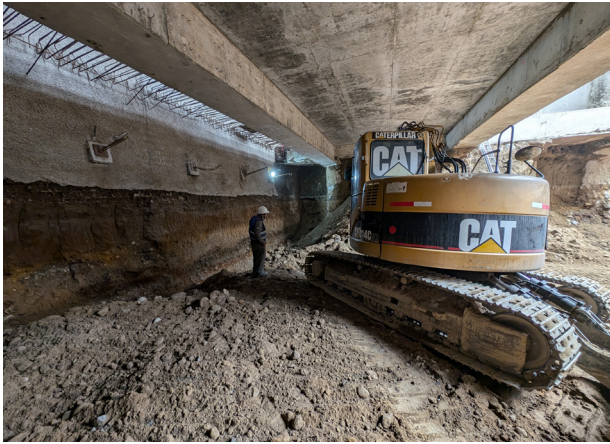
Figura 9. Subexcavación por debajo de la losa diafragma.
