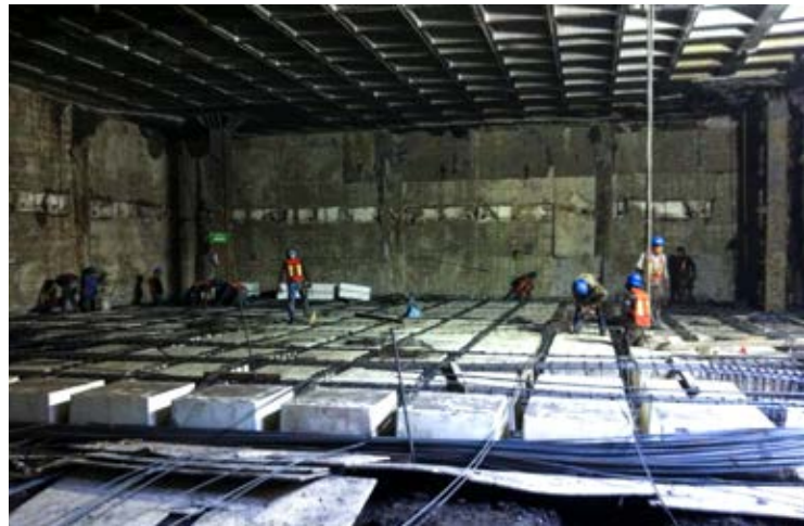
Proceso en el que se lograron dos niveles de subexcavación para permitir la trabajabilidad del equipo.
