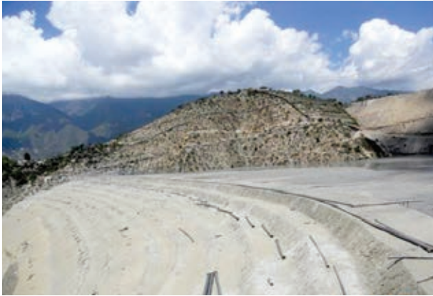
Figura 1. Concauidad hacia aguas abajo y el estanque de agua clarificada alejado, sin afloramientos de agua en el talud externo.
