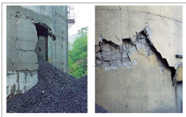
Figura 3. Falla en las paredes de un silo.
