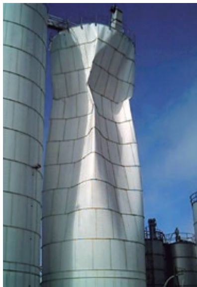
Figura 1. Falla de silo metálico por problemas de flujo en carga y descarga.
