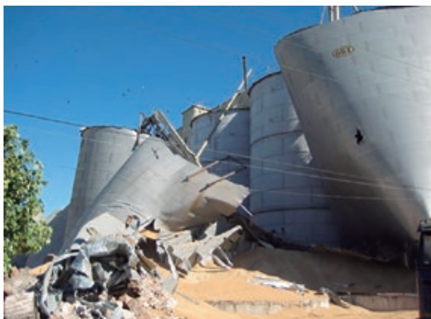
Figura 2. Colapso de silo por fuerza sísmica.
