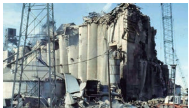
Figura 4. Explosión de un silo de concreto en Westwego, EUA.
