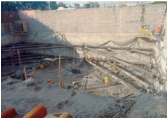
Diseño y construcción de muro Milán apuntalado. Av. Cuauhtémoc, Cd. de México
