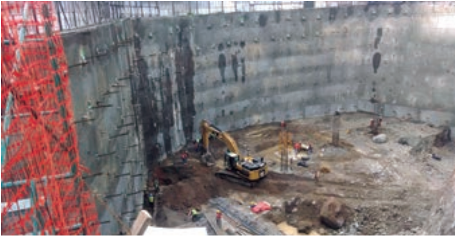
Diseño y construcción de anclas y concreto lanzado. Santa Fe, Cd. de México
